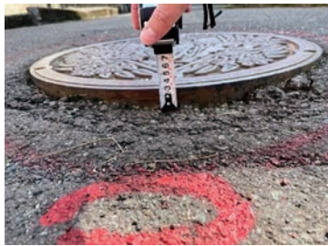
マンホール周辺の沈下
