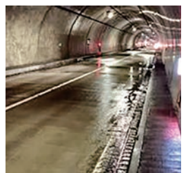
新大島トンネルの湧水
