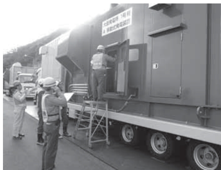
<空冷式非常用発電装置の起動訓練>
